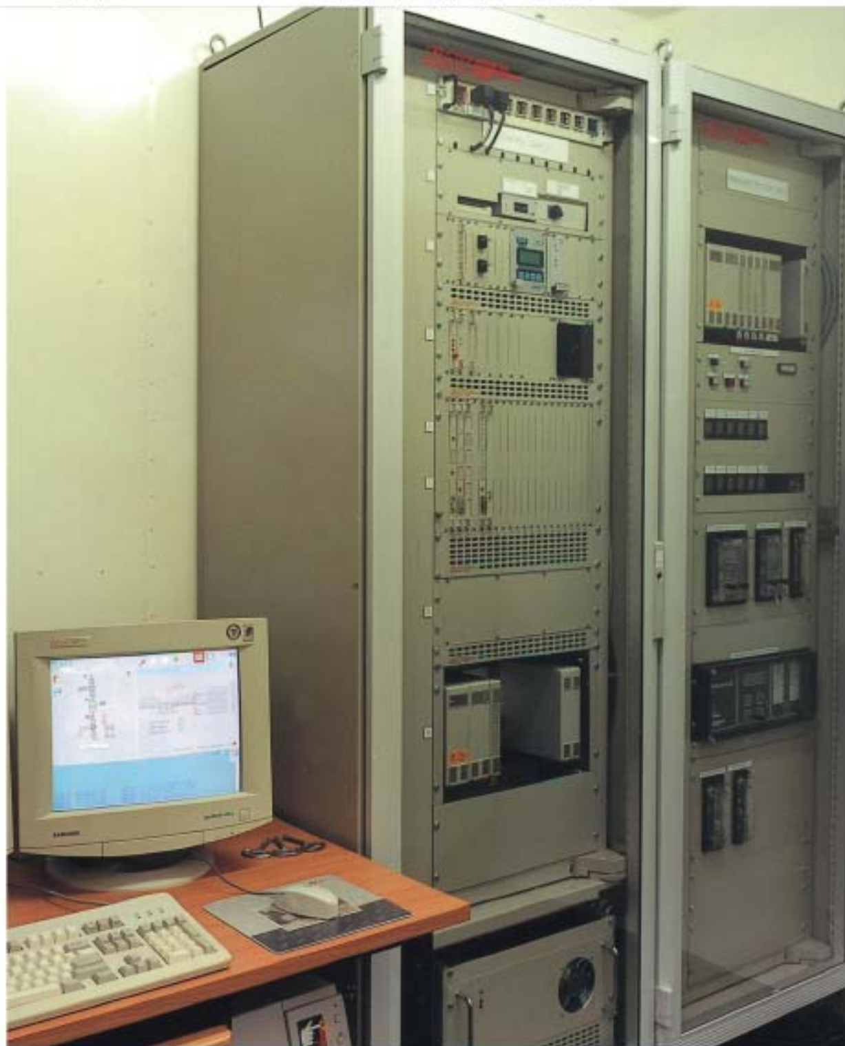
马来西亚TNB 90MVA132/33KV模块式电站控制和保护装置
