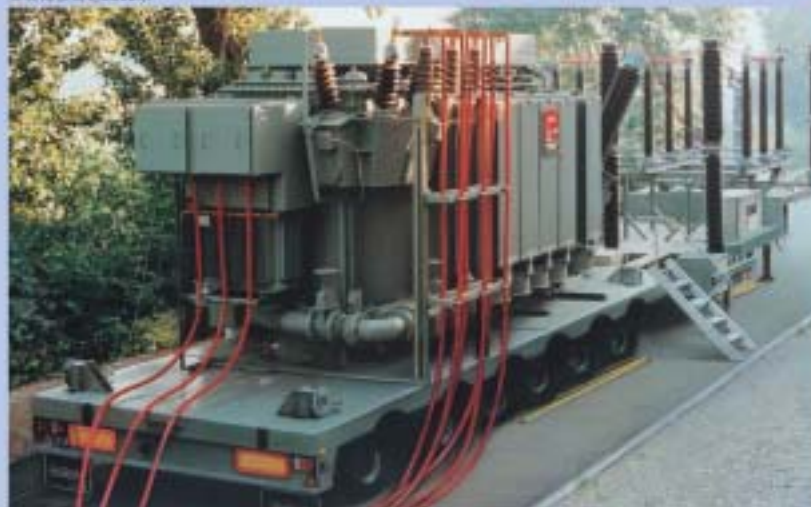
40MVA, 132KV, 两回中压绕组13.8KV/03KV, 空载损耗高达3000K
